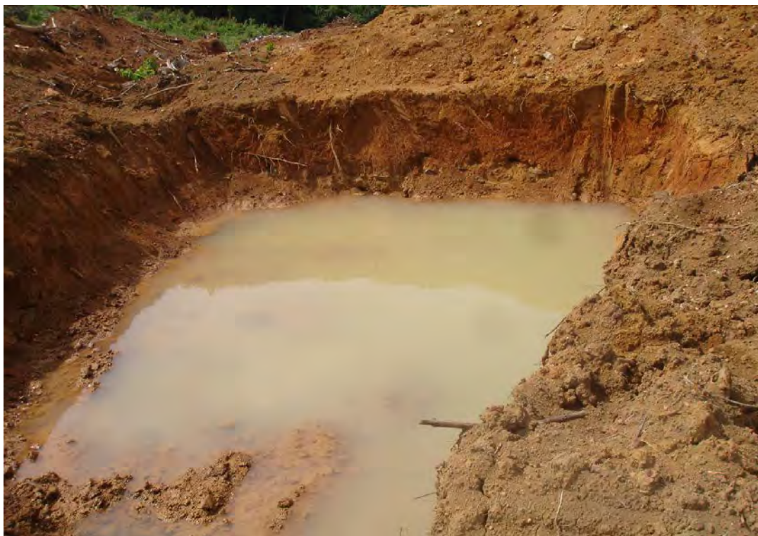
Foto 11 - Poço de recepção de água pluvial do sistema de drenagem na área em lavra.
