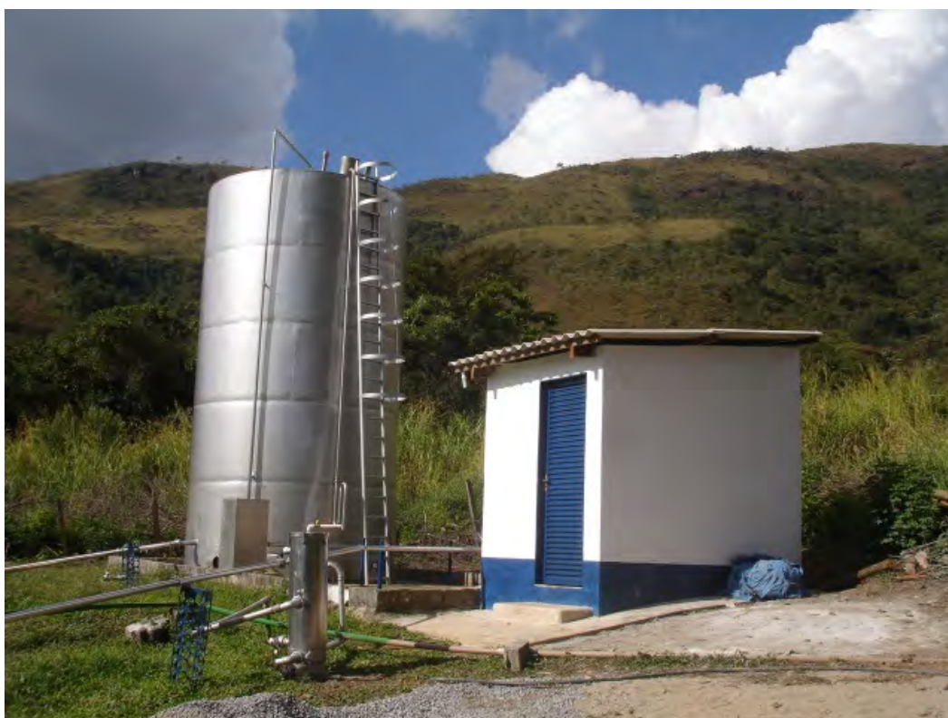
Foto 22 – Instalações do poço de captação de água mineral da Mineradora Serra da Prata em Águas da Prata.
