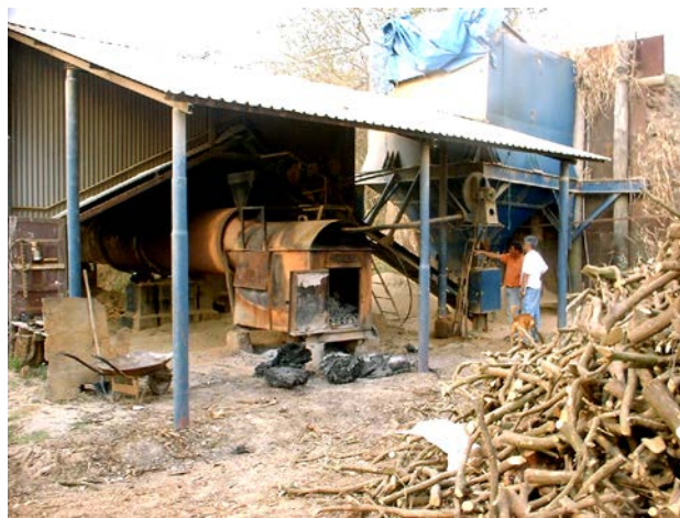
Foto 10 - Instalações de secagem de areia (forno e sistema de transferência) para acondicionamento visando sua comercialização (Mineração São Carlos).
