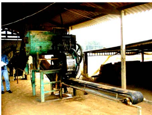
26 – Máquina para fabricação de tijolo cavado.
