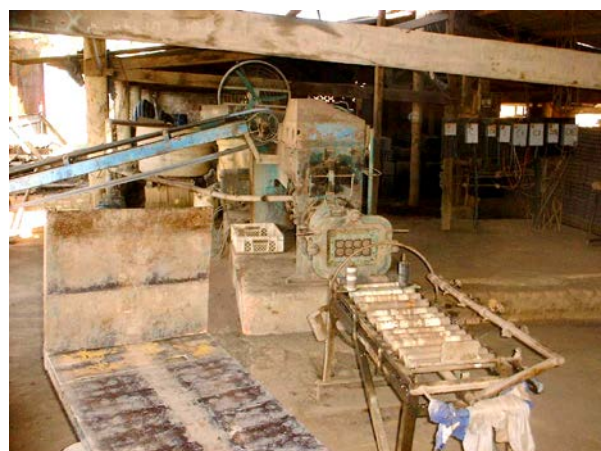
17 – Extrusora para fabricação de tijolo baiano 8 furos.
